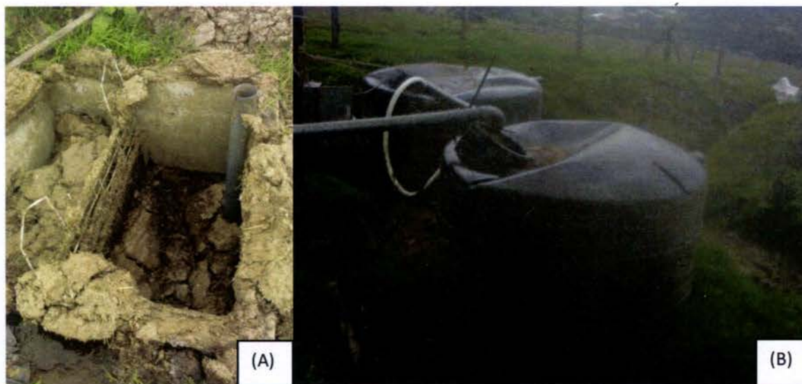
Figura 7. Sistema para el manejo de excretas bovinas (A- Separador de sólidos sin mantenimiento; B- Tanques de purines).
