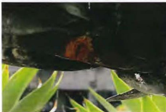
Imagen 61. Expansión de la corrosión en el bronce y cloruros
