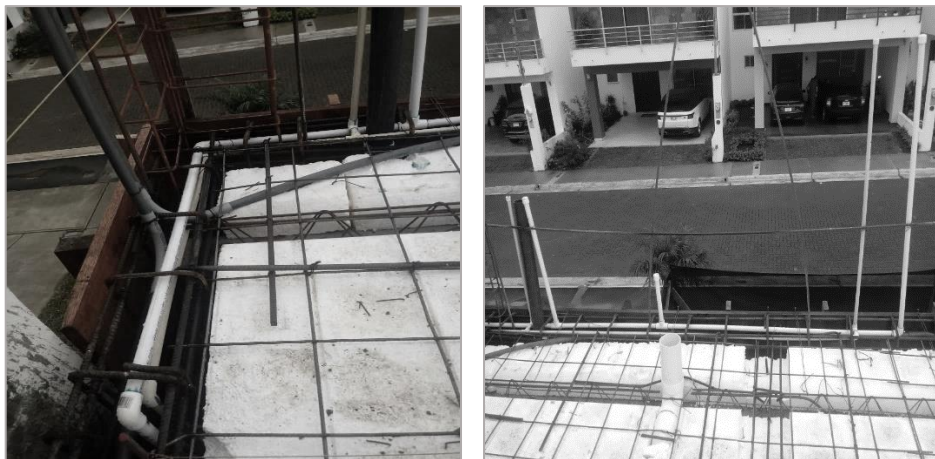
Figura 31. Red de distribución de agua potable en segundo nivel de la edificación
