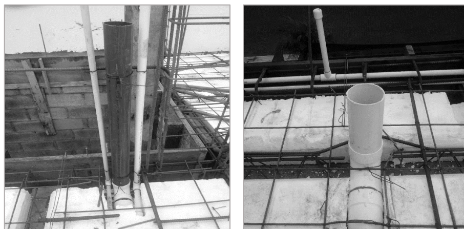
Figura 45. Red de tuberías sanitarias en segundo nivel de la edificación
