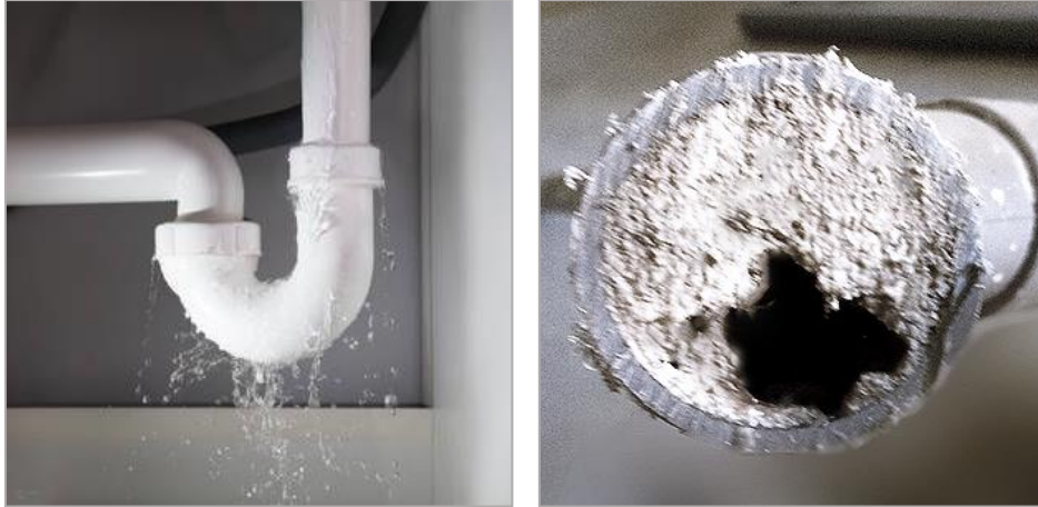
Figura 8. Obstrucciones en sistema de desagüe sanitario
