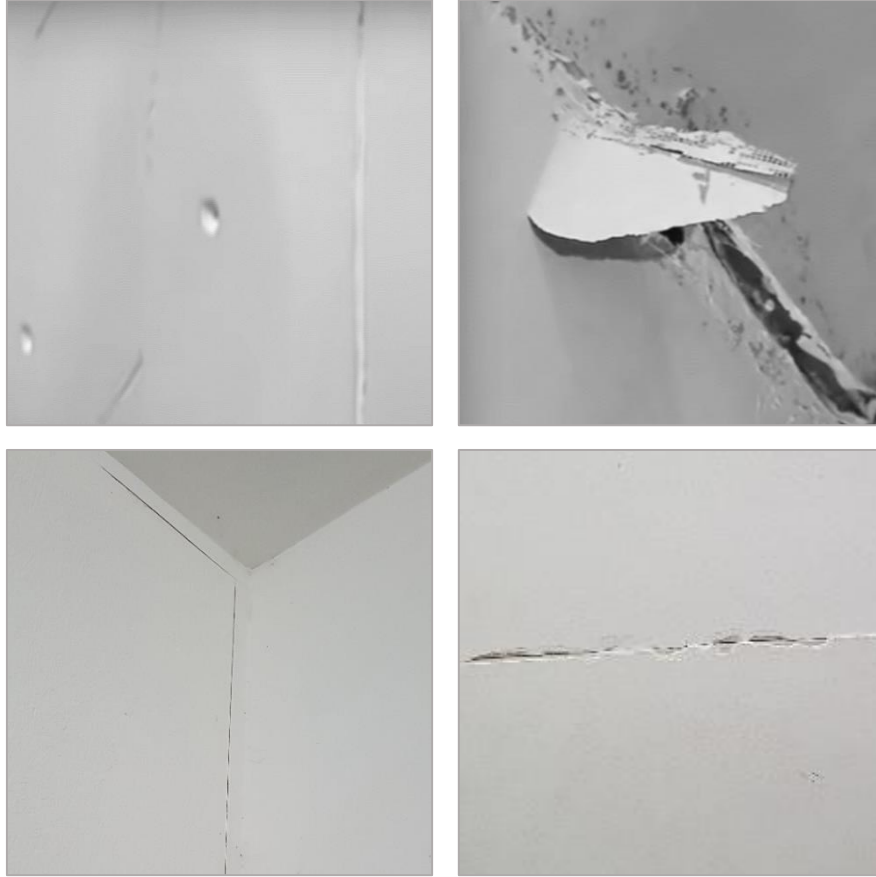
Figura 16. Defectos comunes en el acabado de paredes livianas
