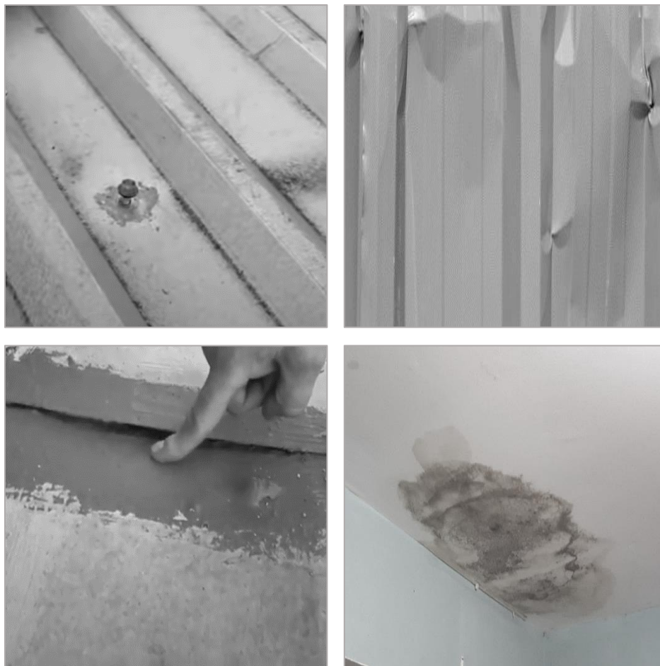
Figura 10. Defectos de construcción de cubiertas de techo
