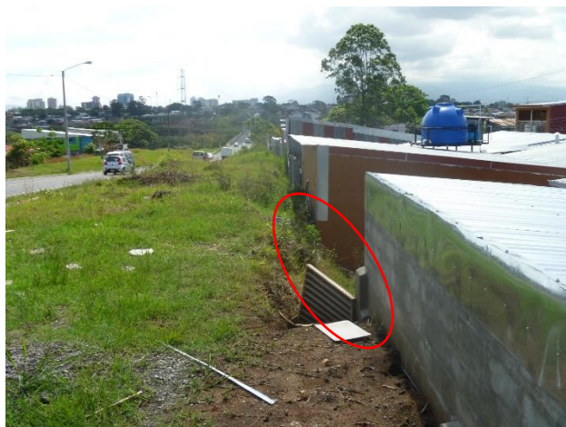
Figura 41 Taludes expuestos en los patios traseros de las casas
