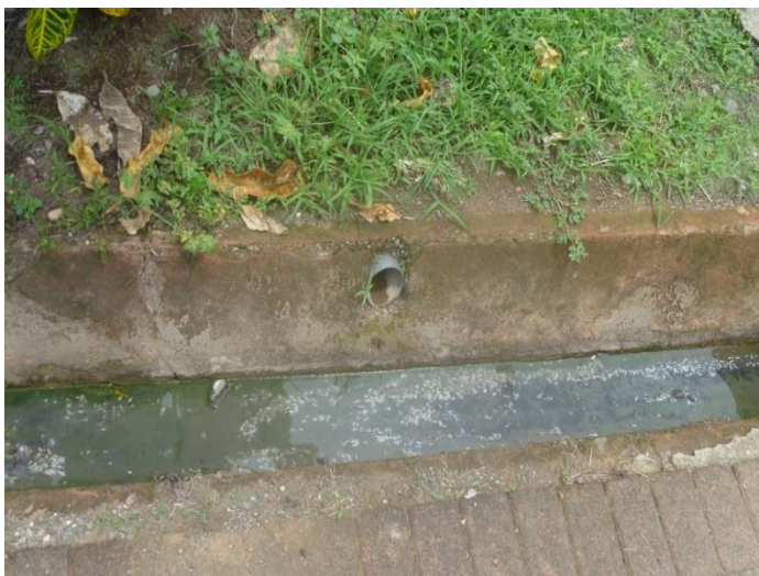
Figura 22 Aguas residuales jabonosas conducidas a los caños
