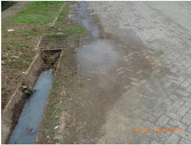
Figura 21 Ejemplo de tragantes localizados en varias partes del proyecto
