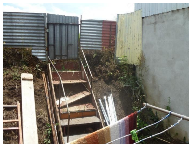
Figura 42 Cara del talud visto desde una de las casas
