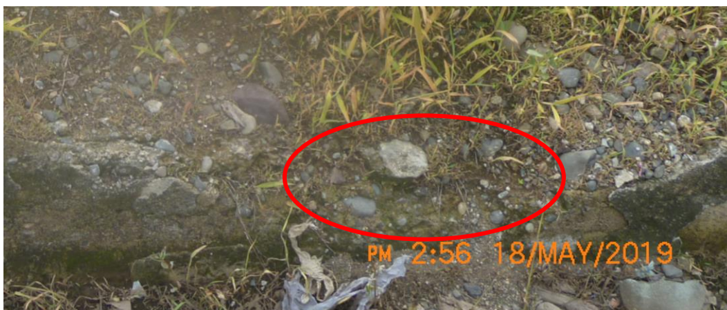
Figura 19 Agregado grueso inadecuado utilizado para elaborar las cunetas
