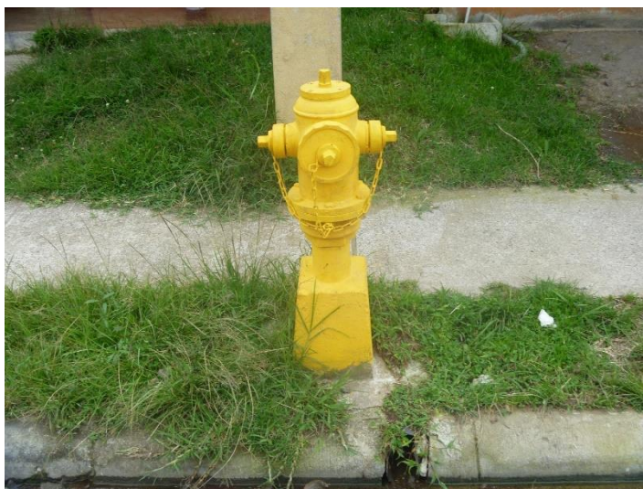
Figura 72 Hidrante ubicado dentro del proyecto
