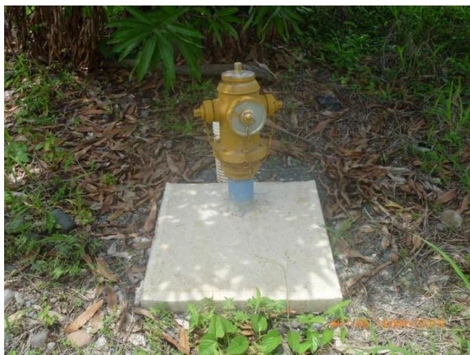
Figura 32 Hidrante presente en el proyecto
