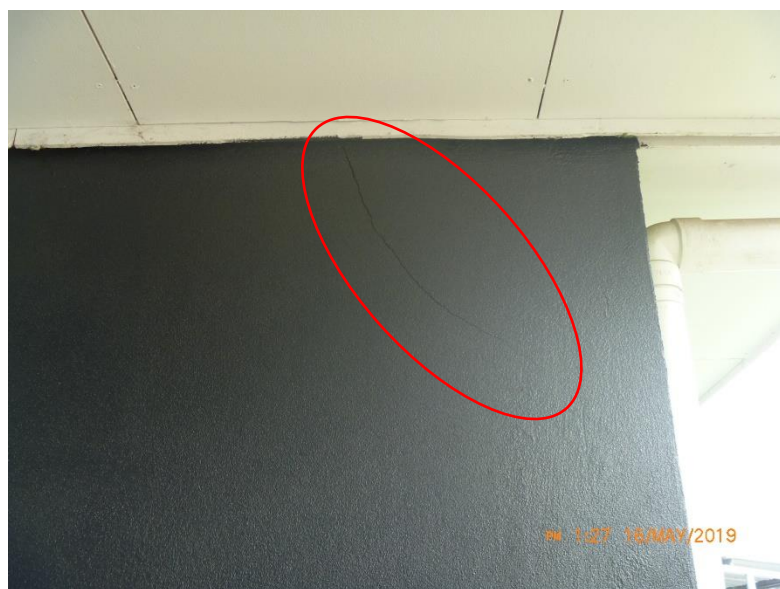
Figura 53 Grietas en las paredes exteriores de las viviendas
