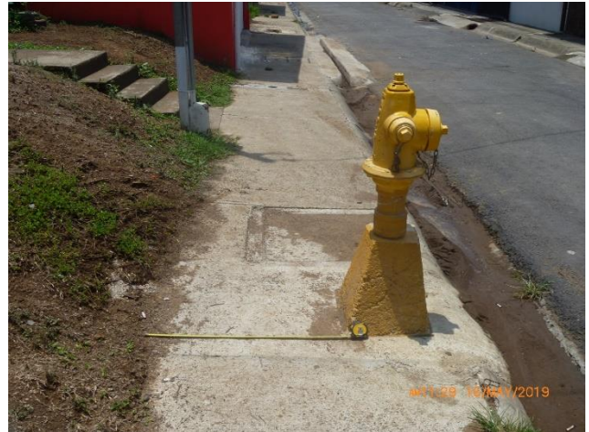
Figura 47 Ancho de la acera reducido por la presencia de un hidrante
