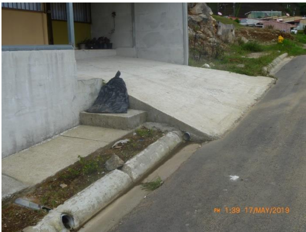
Figura 66 Rampas para vehículos que afectan el funcionamiento de alcantarillas y aceras
