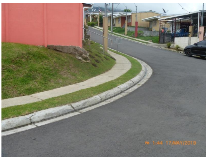
Figura 67 Estado de las aceras del proyecto
