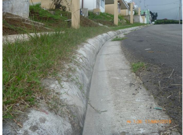
Figura 65 Estado de las alcantarillas del proyecto
