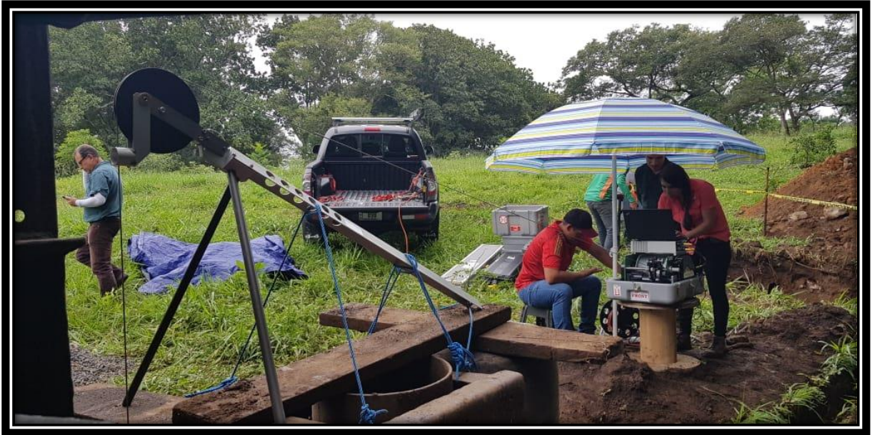
Fig. 60. Ubicación del “winch” y correcta protección del equipo.
