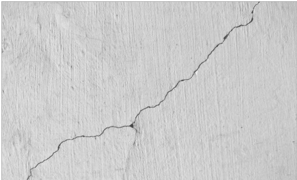
Figura 21. Ejemplo de fisura por sobrecarga Fuente: Martínez, 2020
