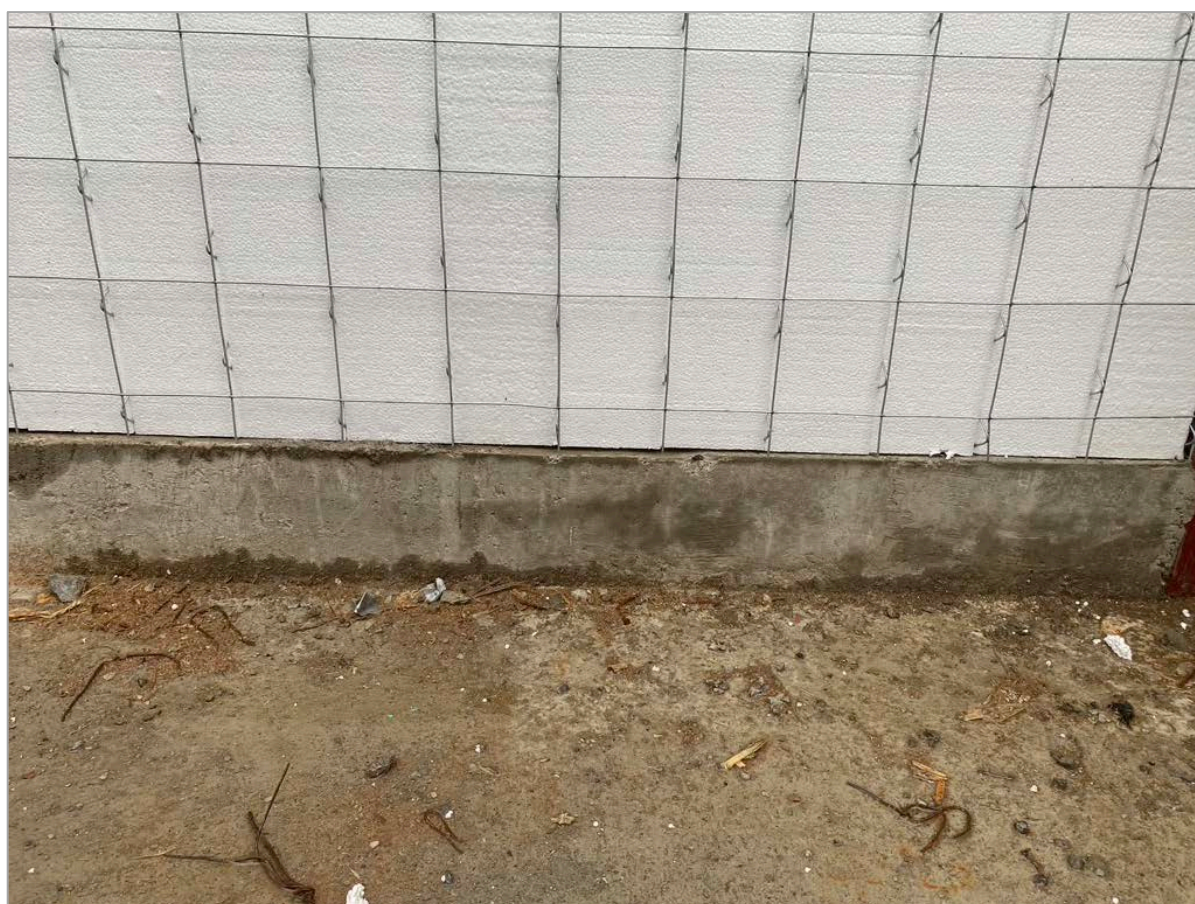
Figura 64. Ejemplo 2 de instalación incorrecta de paredes tipo electro panel Fuente: Elaboración propia
