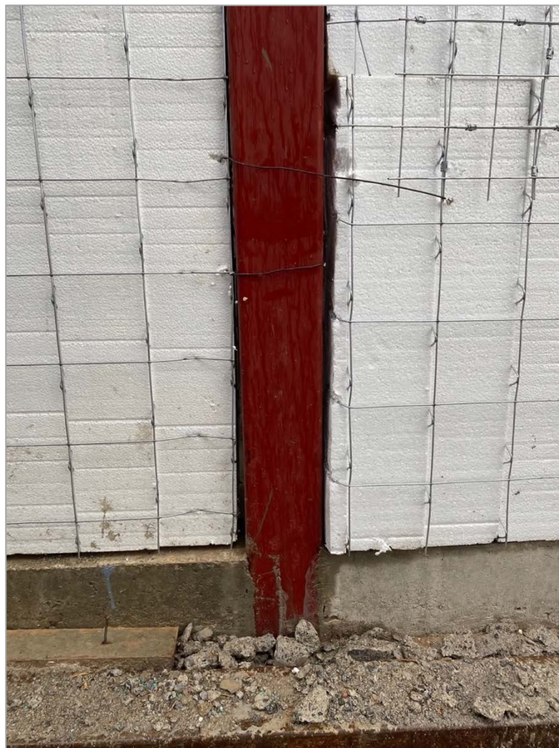
Figura 63. Ejemplo 1 de instalación incorrecta de paredes tipo electro panel Fuente: Elaboración propia
