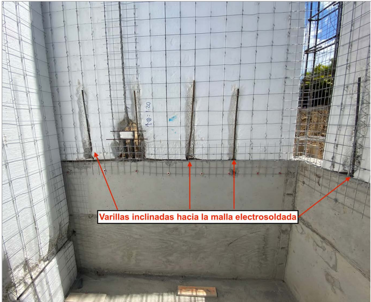
Figura 65. Ejemplo 3 de instalación incorrecta de paredes tipo electro panel Fuente: Elaboración propia
