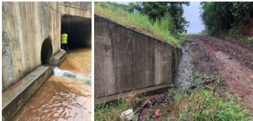
Figura 36. Alcantarillas cortan las pasarelas de acceso en el paso M5
