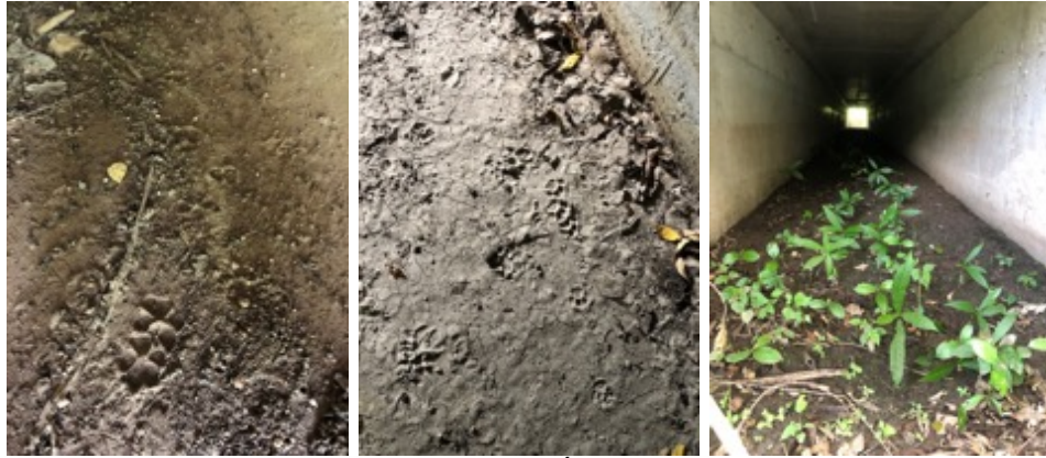
Figura 44. Presencia de huellas y vegetación en la parte interior de los pasos
