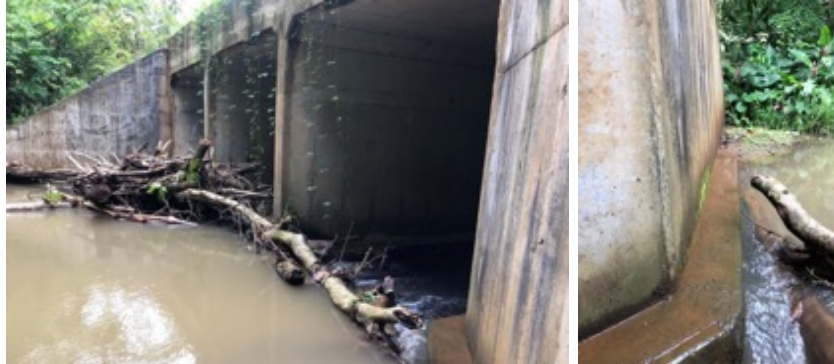
Figura 37. Paso mixto S1, escombros en entrada de drenaje (izquierda) y modificación de pasarela (derecha).
