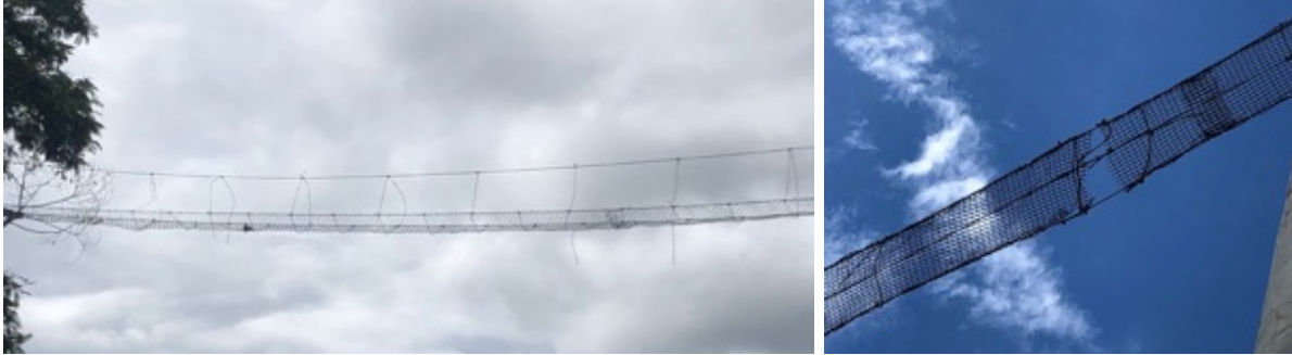
Figura 32. Paso A11 de la Ruta N° 4 con 8 triángulos rotos y paso A9 de la Ruta N° 1 con la malla rota
