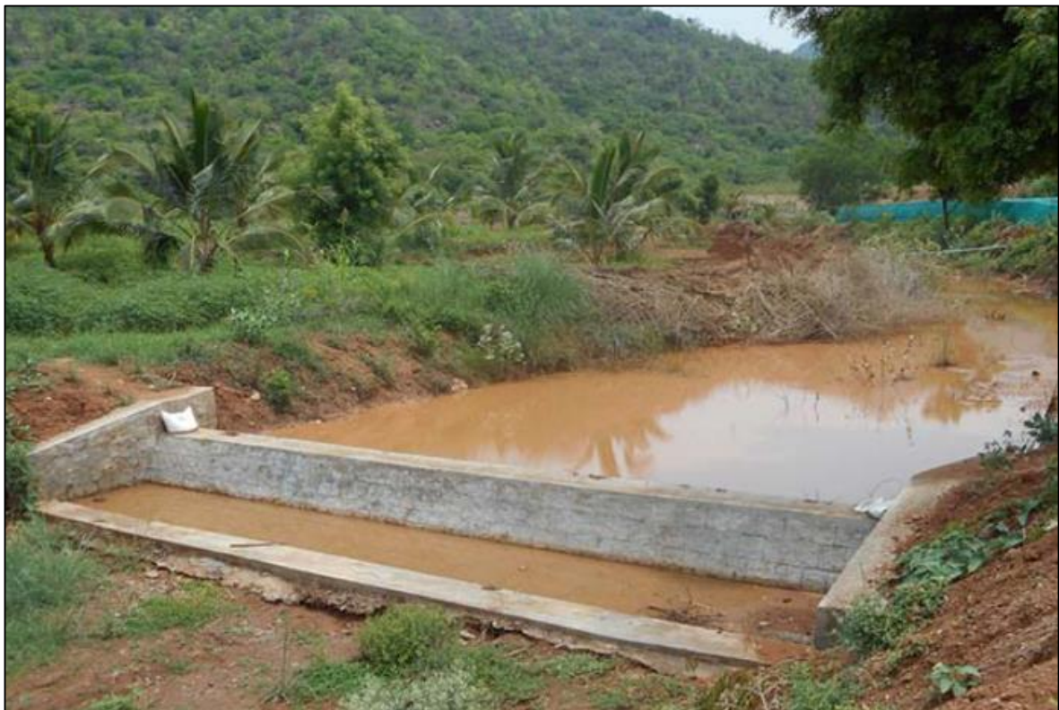
Figura B-3. Presa filtrante Fuente: (DTNEXT, 2021)
