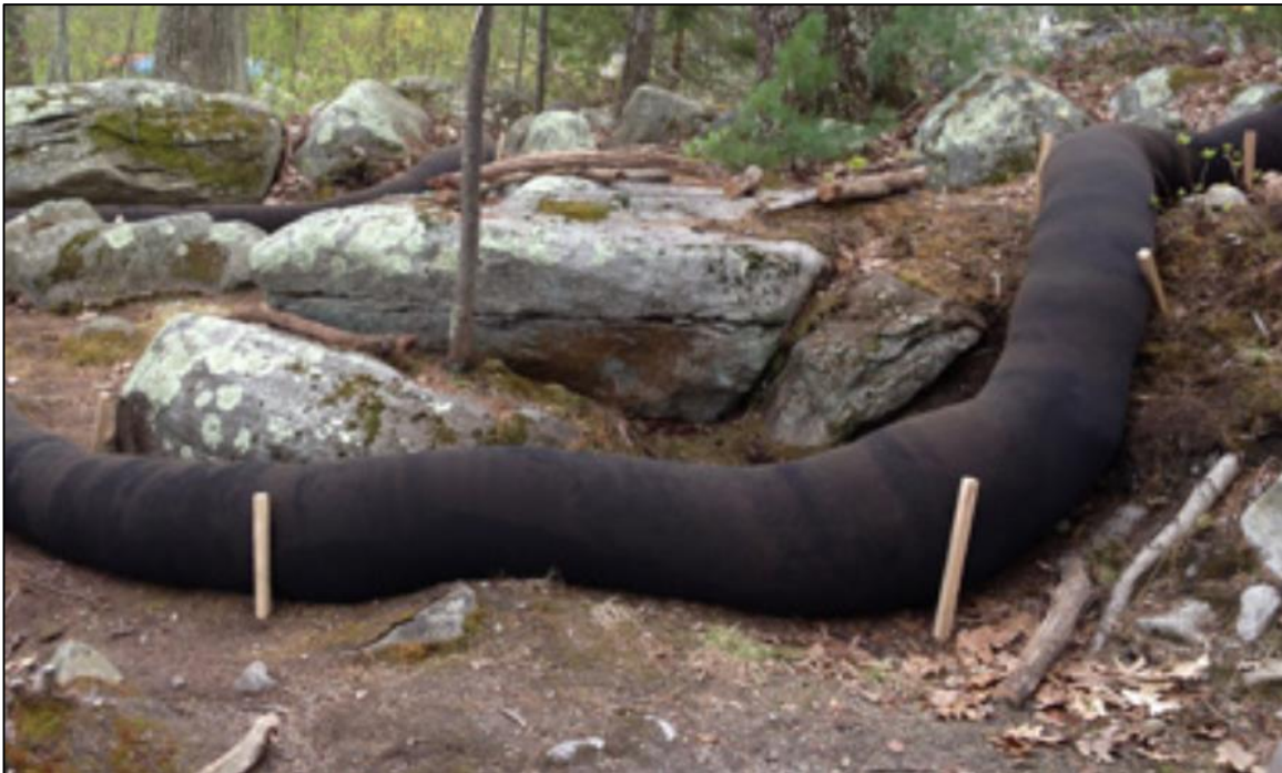
Figura B-5. Media filtrante de compost en entorno natural Fuente: (Meadowbrook, 2015)
