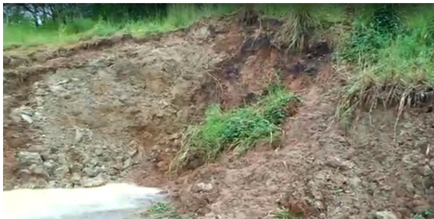
Deslizamientos de lotes.
