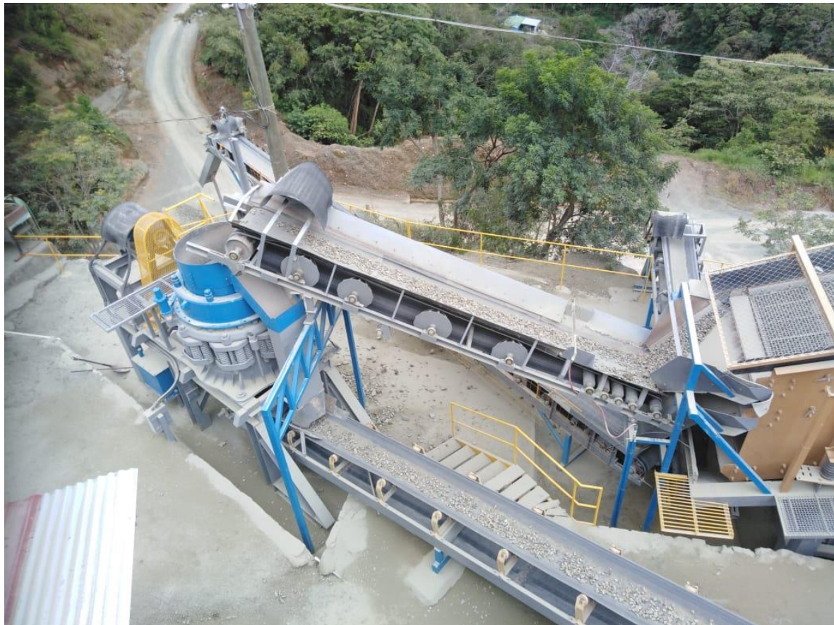
Figura 7: Ejemplo de criba y bandas transportadoras de material
