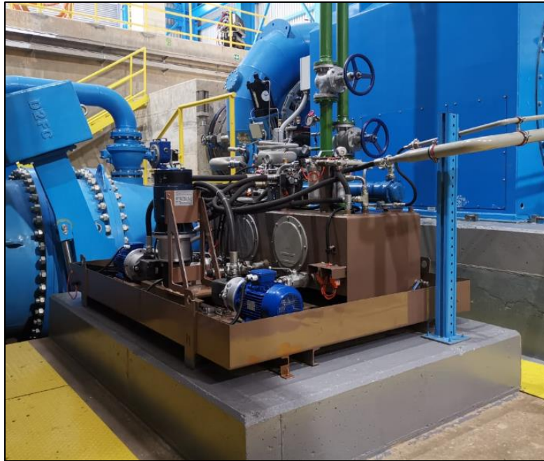
Ilustración 3.13. Unidad de lubricación con bandeja de contención de derrames en su base. Fuente: Autores.
