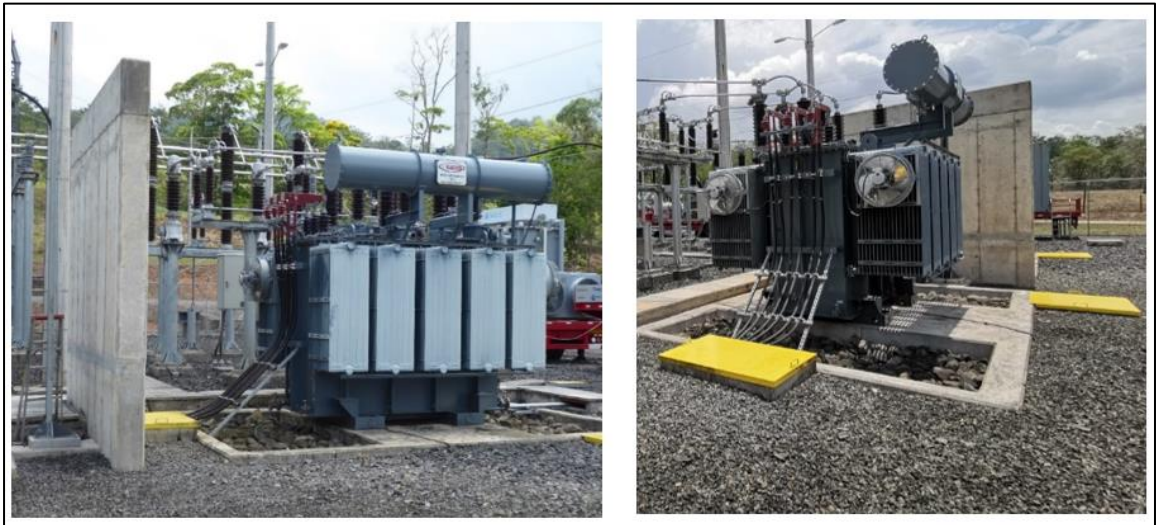
Ilustración 3.6. Muro corta fuego que separa los transformadores de la planta. Fuente: Autores.
