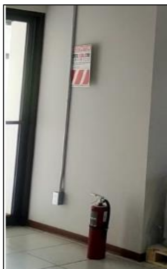
Ilustración 4.8. Extintor en cuarto eléctrico. Fuente: Autores.
