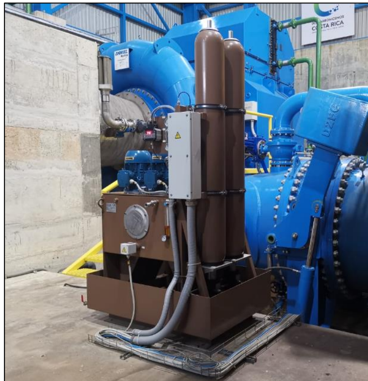
Ilustración 3.14. Unidad oleo-hidráulica con bandeja de contención de derrames en su base. Fuente: Autores.
