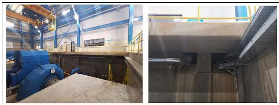
Ilustración 3.4. Trincheras de los cuartos de control hacia cuarto de turbinas y generadores. Fuente: Autores.
