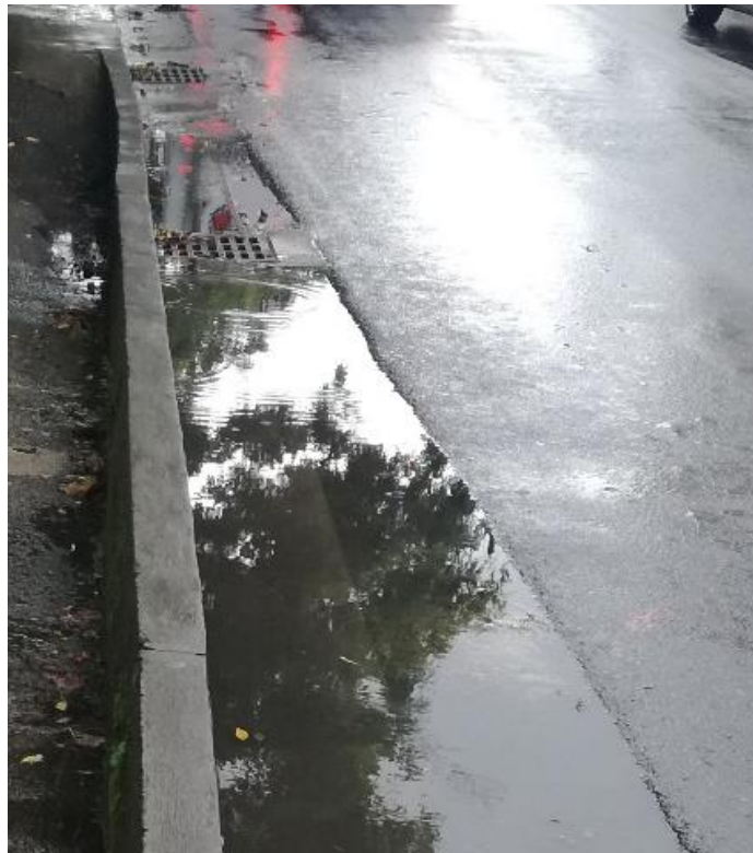
Figura 58. Ubicación inadecuada del tragante
