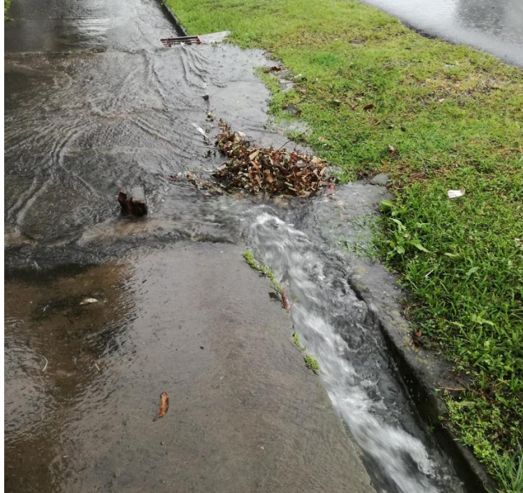
Figura 59. Obstrucción del cordón y caño
