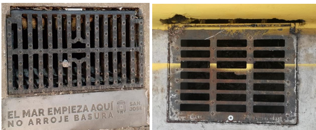
Figura 62. Rejas con disipadores de energía que facilitan el ingreso
