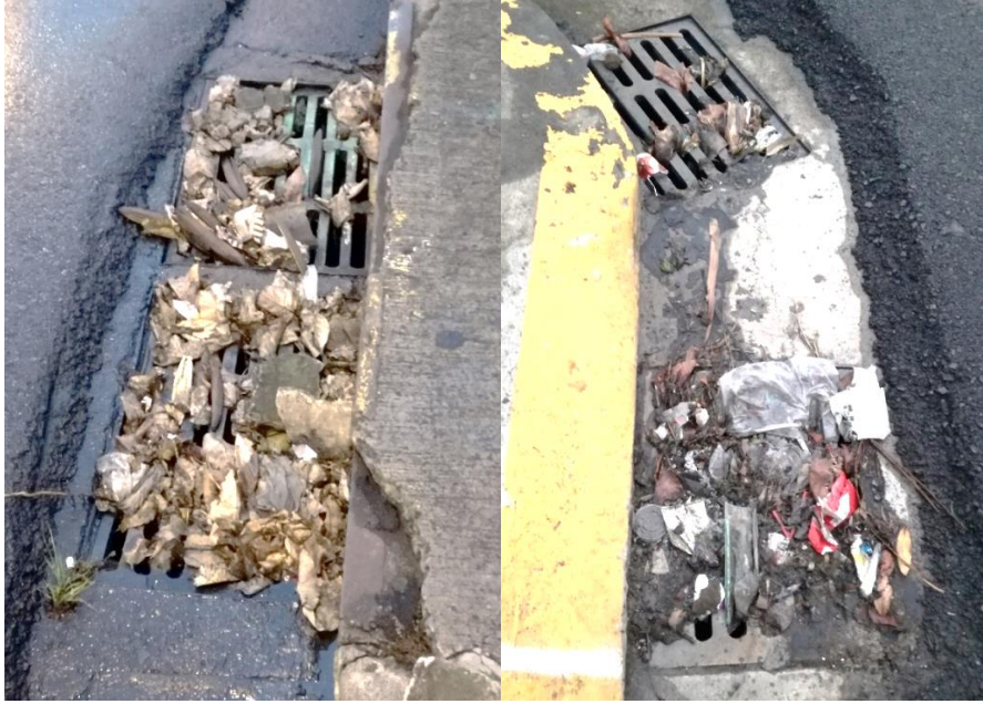
Figura 57. Obstrucción de rejillas
