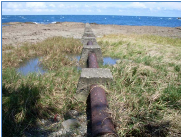
Fotografía 11: Tubería expuesta causado por ascenso tectónico en 1991.
