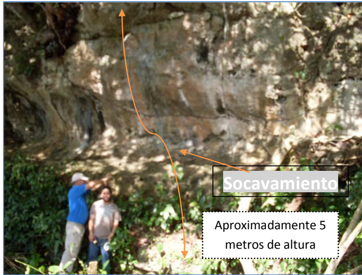
Fotografía 10: Socavamiento por oleaje en antigua plataforma de bajamar, extremo este de Bahía Portete.
