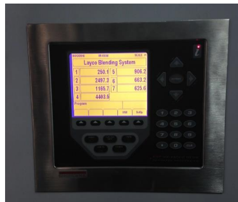
Figura 4.5. Pantalla de estado de tolvas.
