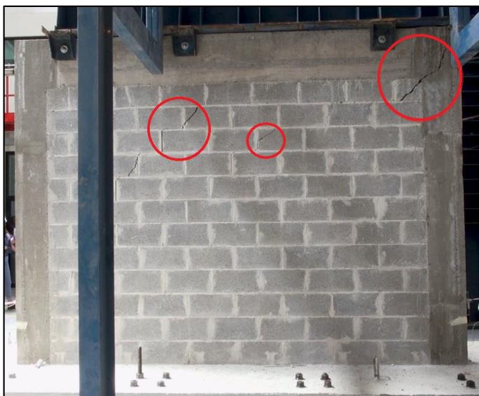
Figura 52. Muro RA.75 agrietado al alcanzar la capacidad máxima \pm 48 mm.
