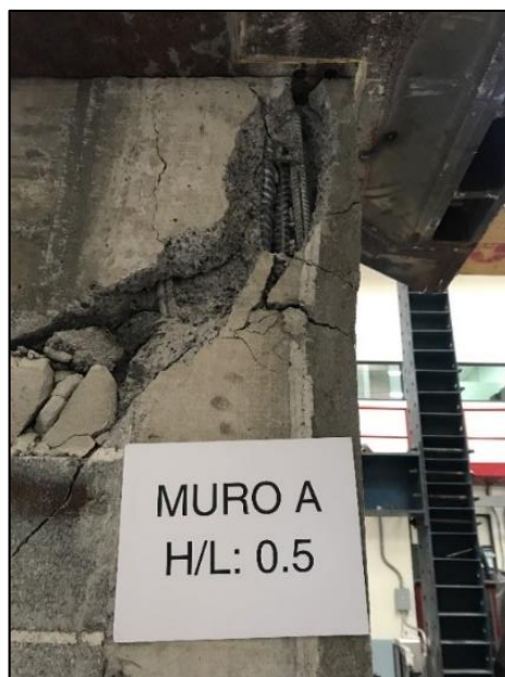
Figura 50. Condición final del nudo Muro RA.5
