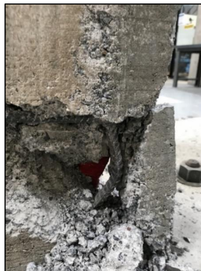
Figura 63. Estado final de la base de la columna Muro RA1.5.
