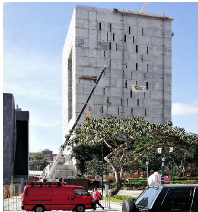
Figura 50: Construcción de nuevo edificio de la Asamblea Legislativa 2019. Fuente: Soto Gómez, D. (2019).
