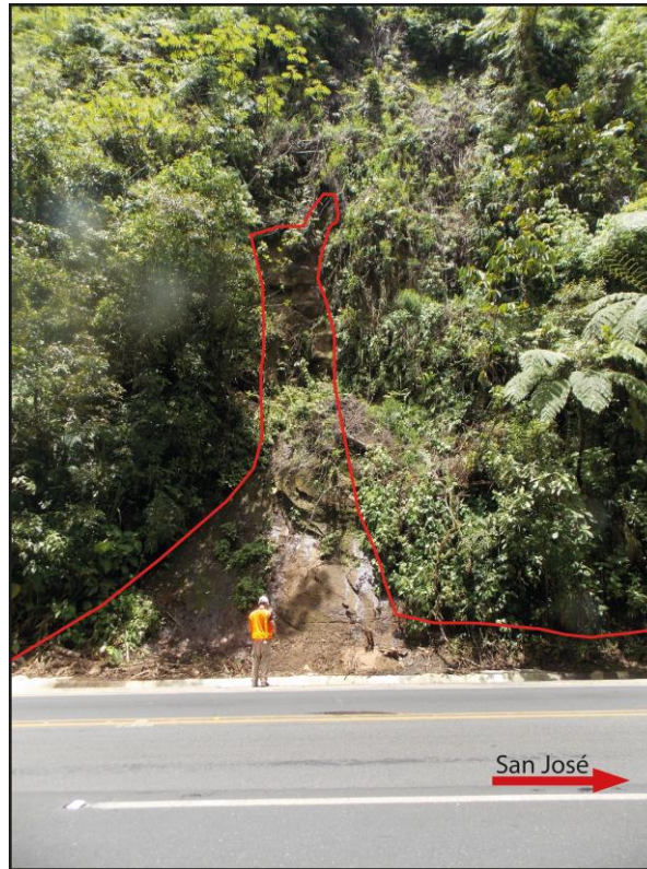
Figura 3.5: Ejemplo de los deslizamientos y afloramientos encontrados en la zona. En la foto se puede apreciar la gran cantidad de vegetación presente en los taludes. Por ser un parque nacional la única forma de acceder a la roca y/o suelo es que estos sean expuestos naturalmente mediante un deslizamiento u otro evento de remoción de masa. En rojo el material expuesto.
