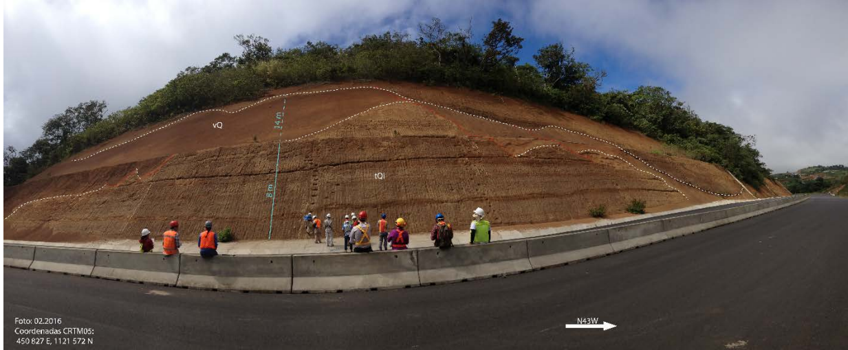
Figura 22: Interpretación del talud en el kilómetro 10+220.
