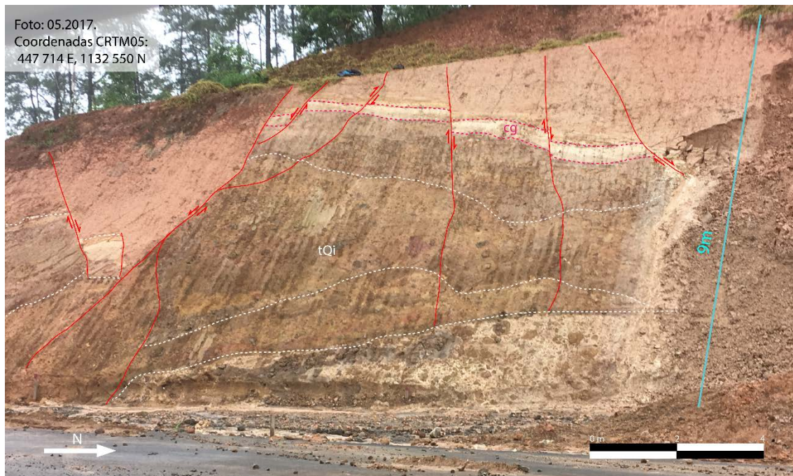
Figura 26: Interpretación del talud en el km 24+620 (intersección hacia Santa Elena).
