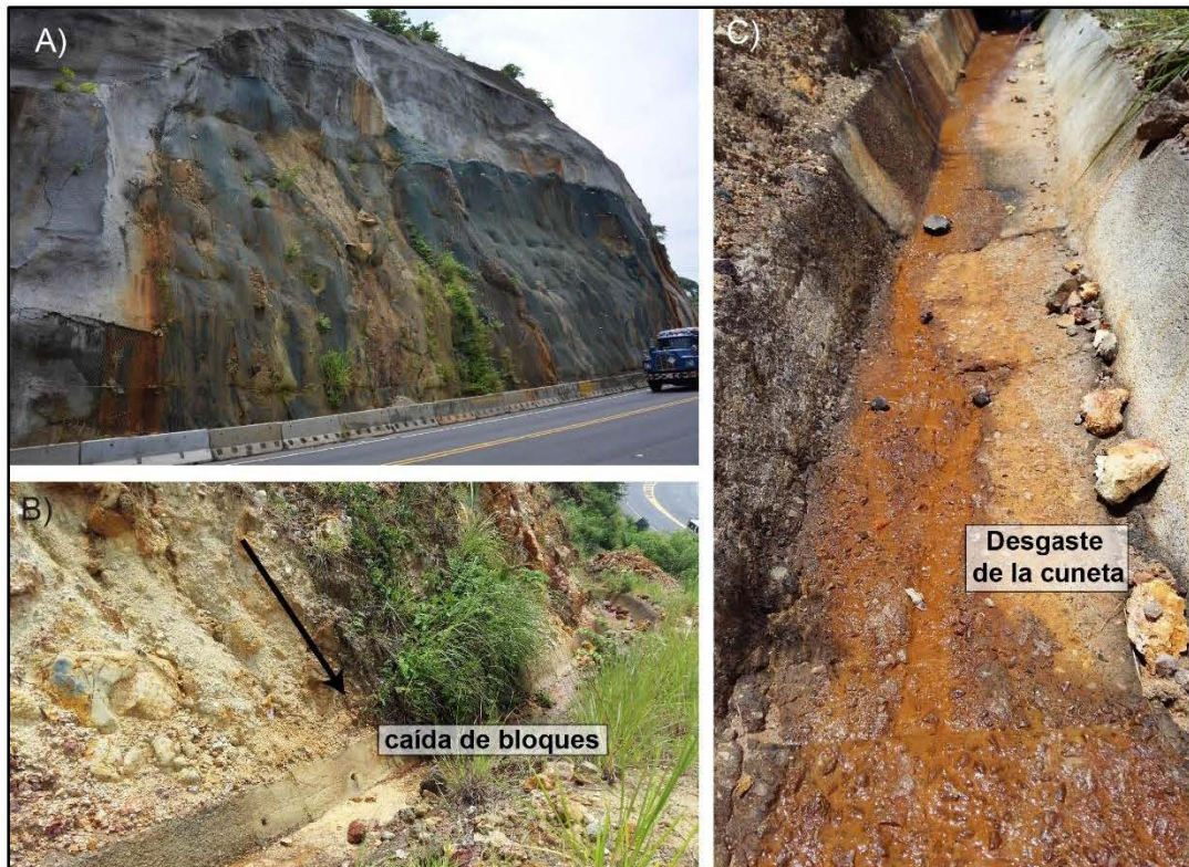
Figura 4. A) Talud derecho del estacionamiento km 38+600, pared recubierta por concreto lanzado y una malla de control de erosión en el sitio donde ya se ha presentado un desprendimiento del concreto lanzado. B) Berma del talud derecho, que presenta presencia de DAR y caída de bloques. C) Desgaste en la matriz del concreto de la cuneta.
