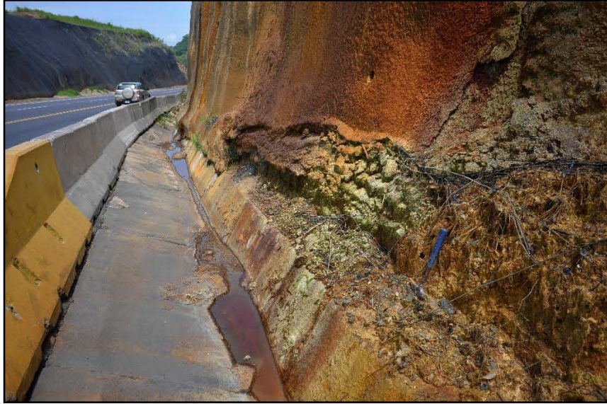
Figura 5. Desgaste del concreto lanzado al pie del talud derecho del km 38+600. Se observa la erosión de finos.
