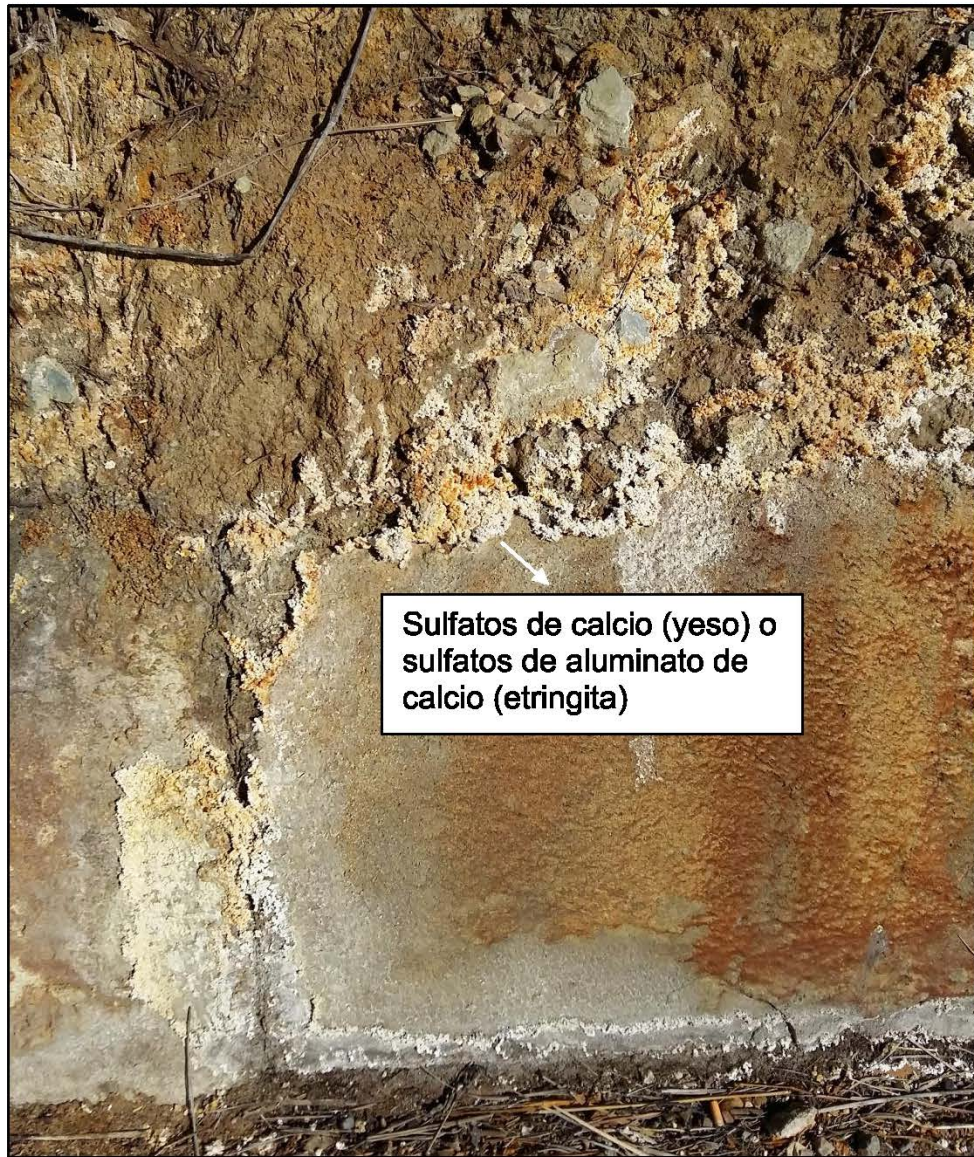
Figura 68. Depósitos de yeso y etringita en cunetas del talud derecho del estacionamiento km 38+600
