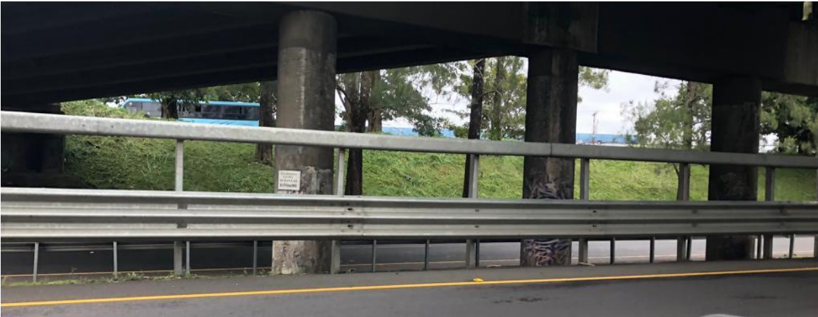
Figura 97. Ejemplo sistema de contención en bases de paso elevado Florencio del Castillo
