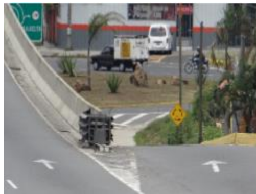
Figura 88. Estado amortiguador este paso elevado Alajuelita
