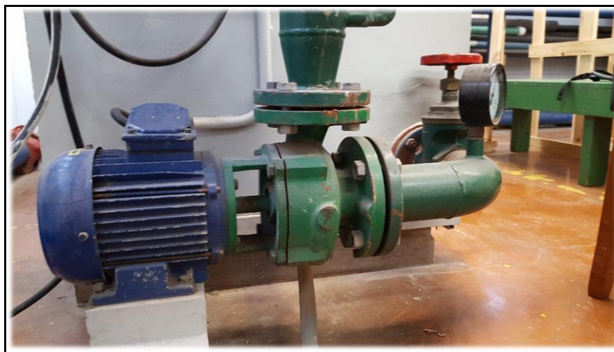
Figura 4.4. Sistema de bombeo empleado para caudales mayores
