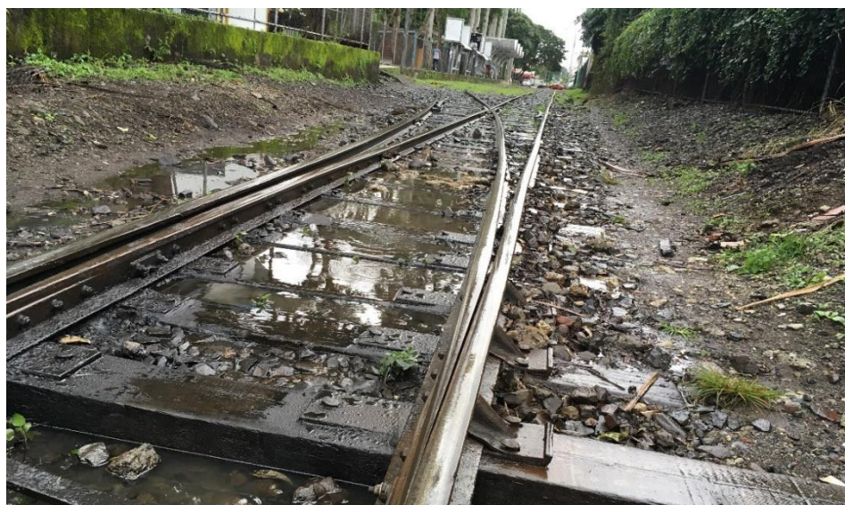
Imagen 13. Imagen urbana deteriorada en las líneas del tren. Fuente: Núñez Vargas, W. (2018).
