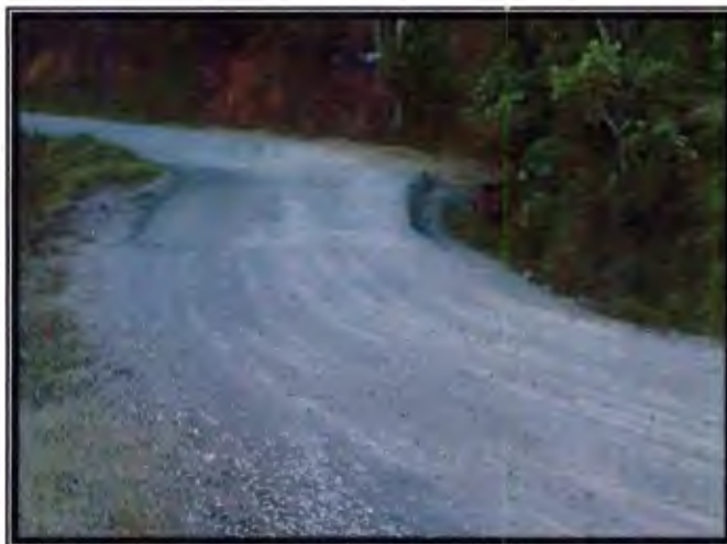
Figura N° 2.12 Hundimiento en la Ruta Nacional N° 228 (coordenadas 201.800N-535.600W, hoja Abra)
