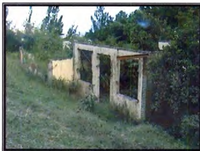
Figura N°2.13 Daños ocasionados por el deslizamiento de Tablón en el año 1999 (coordenadas 201.800N-535.600W, hoja Abra)
