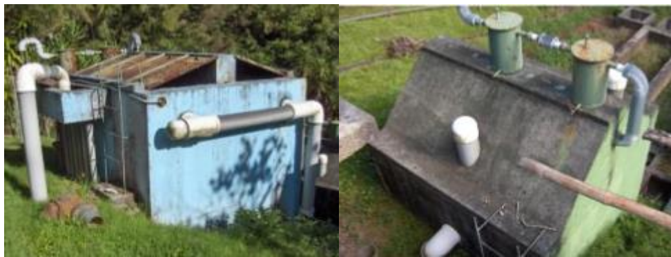
Figura 31. Reactor UASB y sistema de recolección de gases previo a las mejoras.
