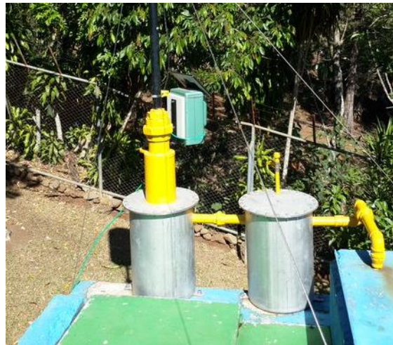
Figura 46. Trampas de humos y de llamas del reactor UASB
