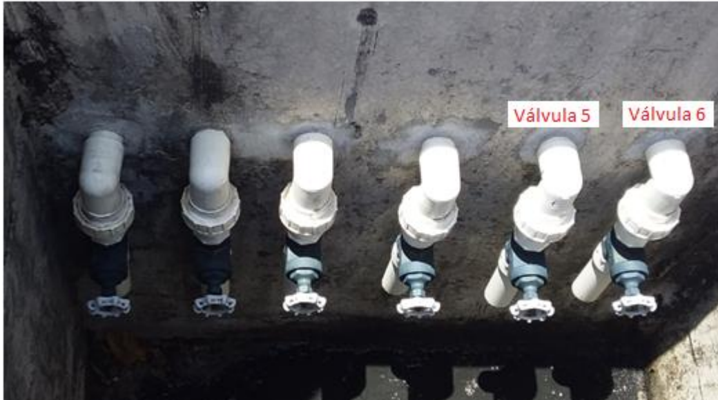
Figura 10. Puntos de muestreo 4 y 5, válvulas de inspección del reactor UASB.
