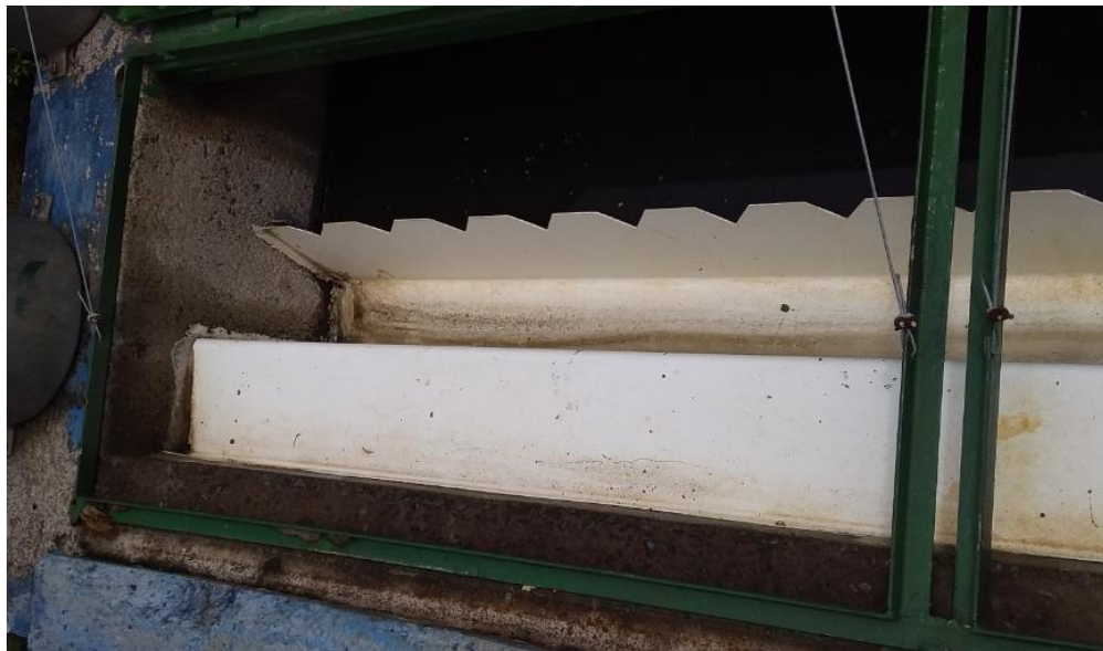
Figura 40. Vertederos triangulares de la canaleta y sellado de las filtraciones
