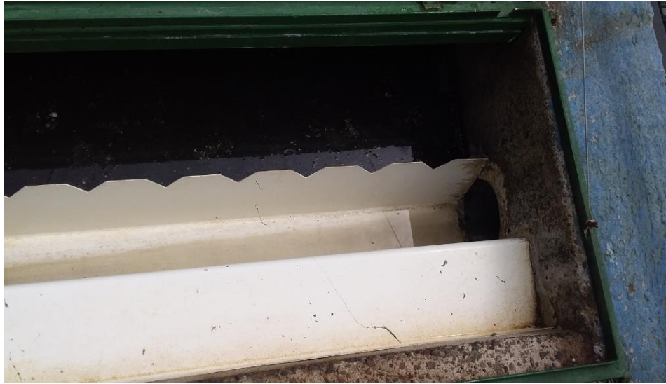
Figura 39. Canaleta de fibra de vidrio y orificio de salida del agua del reactor UASB
