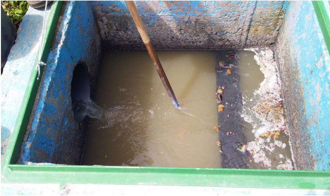
Figura 34. Entrada al desarenador de la planta de tratamiento de Santa Cecilia
