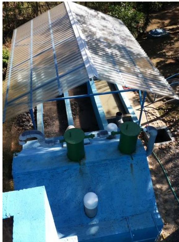
Figura 51. Digestor de lodos y lecho de secado de lodos
