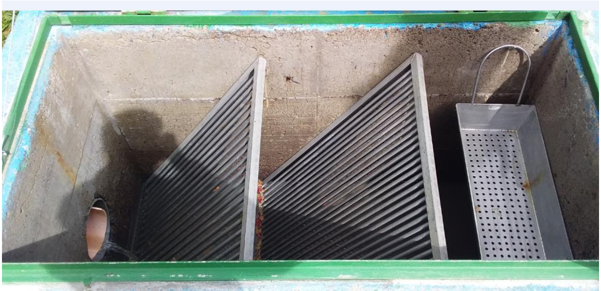
Figura 33. Caja de rejas de la planta de tratamiento de Santa Cecilia
