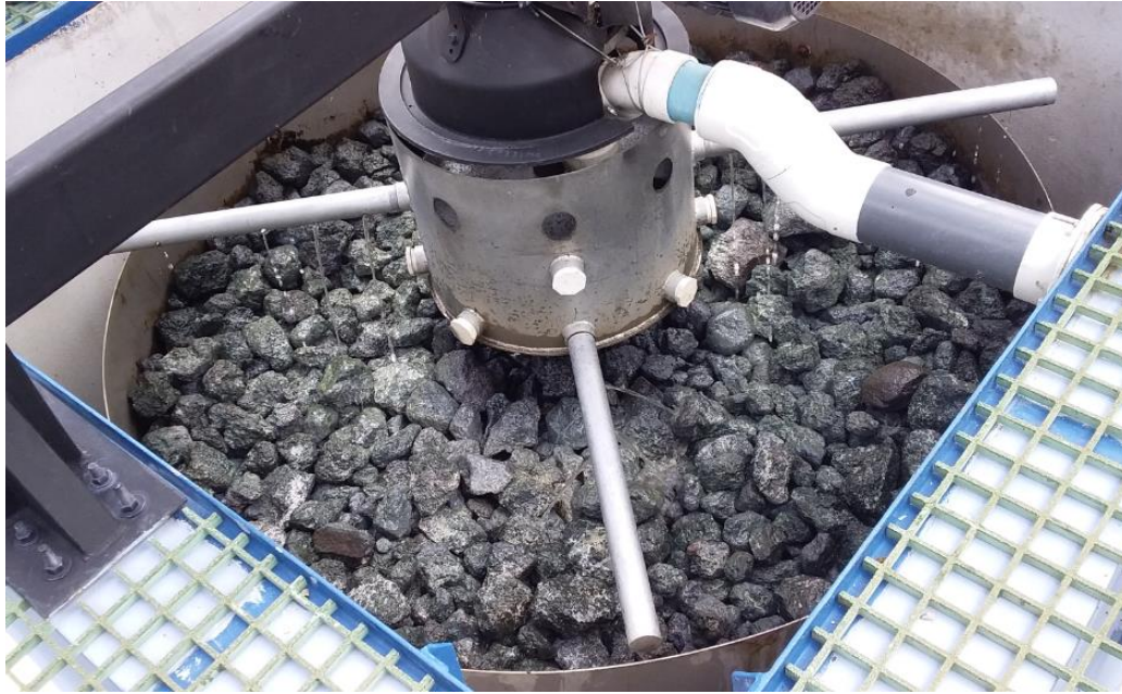
Figura 8. Punto de muestreo 2, entrada al filtro percolador y salida del UASB.
