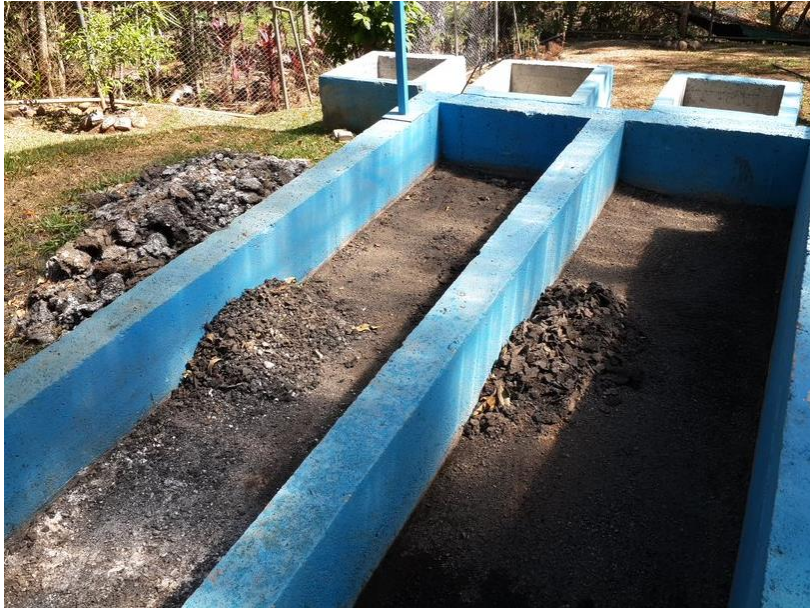
Figura 52. Lecho de secado de lodos de la PTAR
