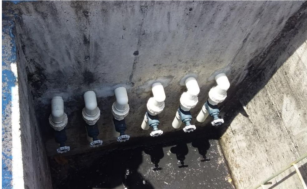
Figura 41. Válvulas de inspección de lodos del reactor UASB
