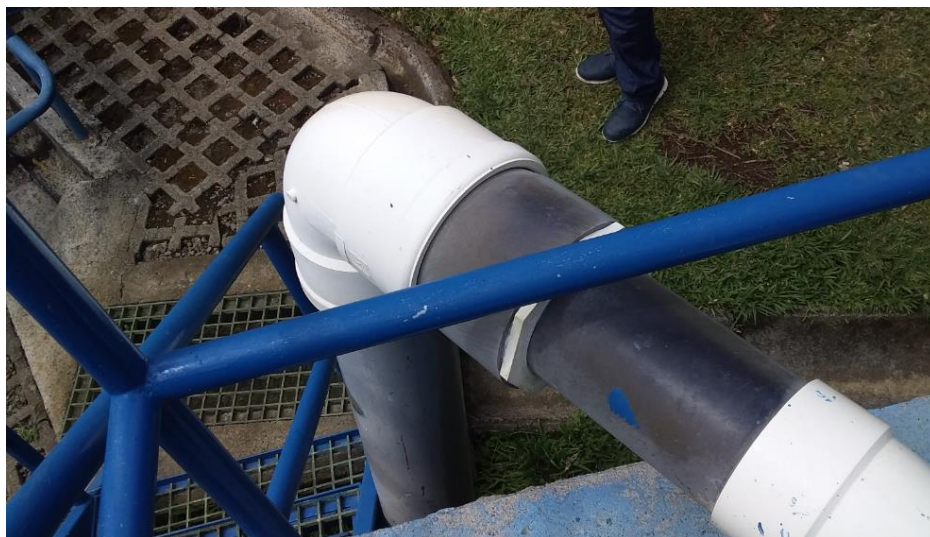
Figura 38. Reducción del tubo de entrada al reactor UASB
