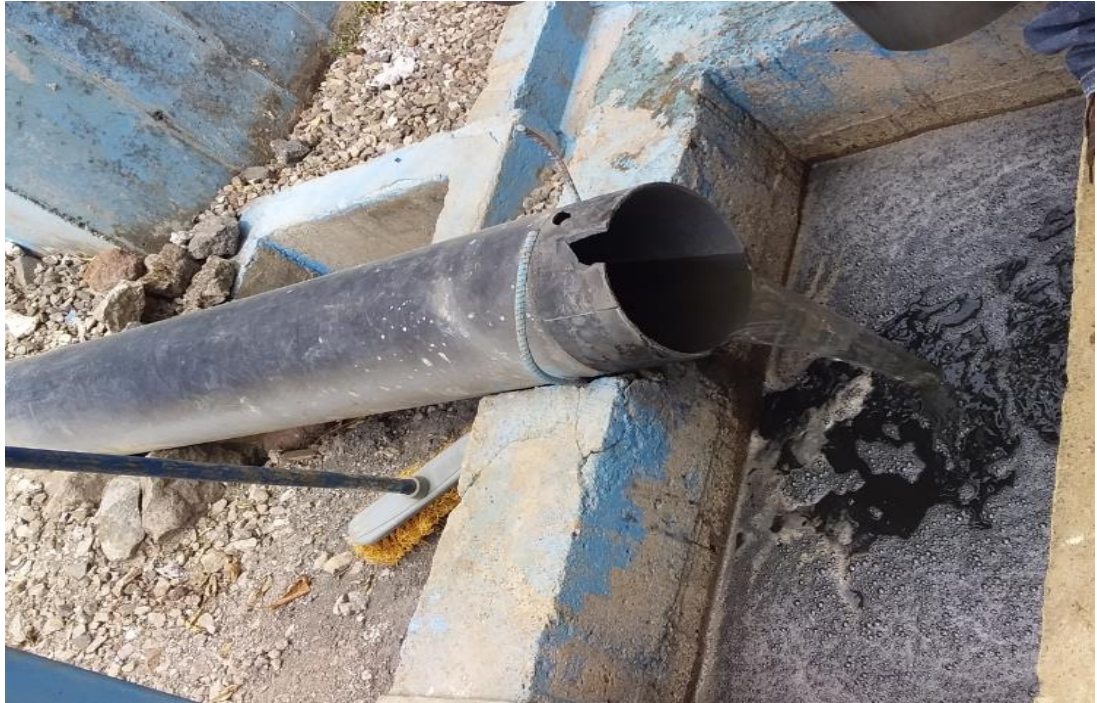
Figura 49. Entrada al sedimentador secundario.
