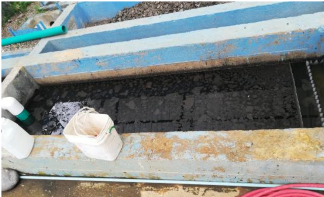
Figura 50. Sedimentador secundario con presencia de sólidos flotantes.
