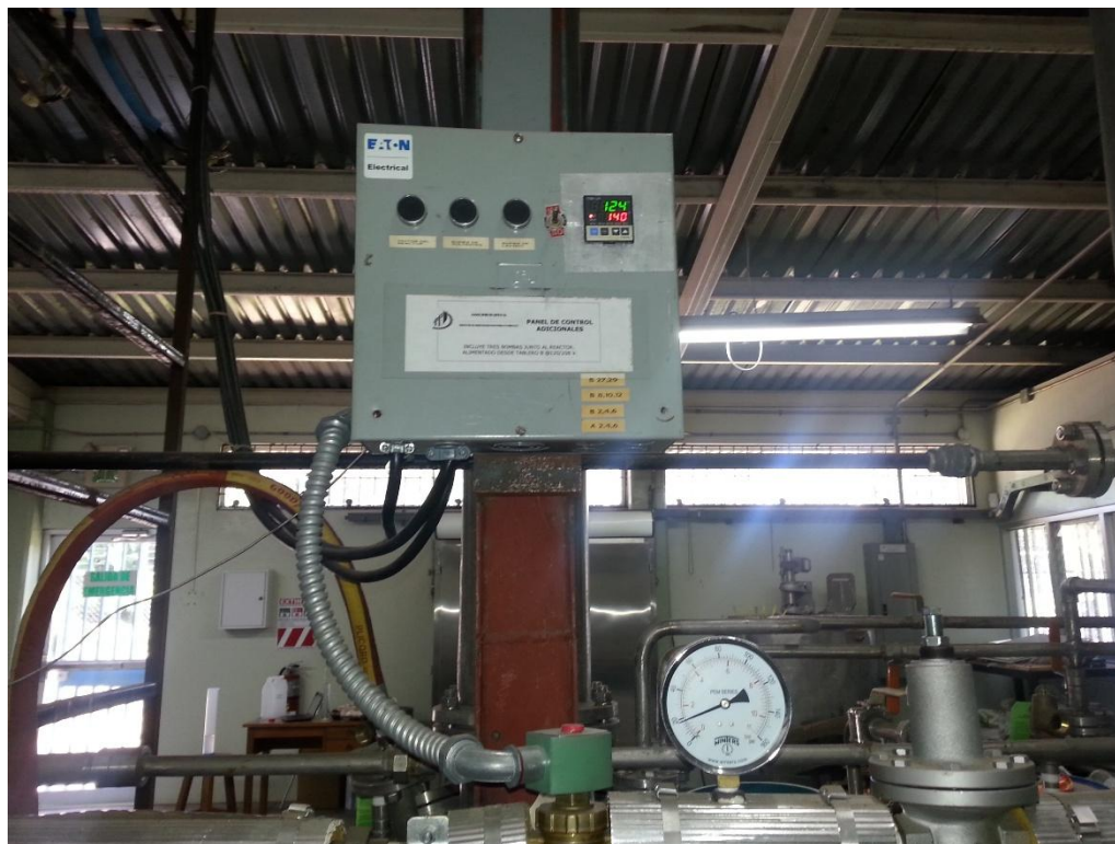
Figura 11. Barómetro, válvula reguladora y tablero de temperatura del destilador de la planta piloto.
