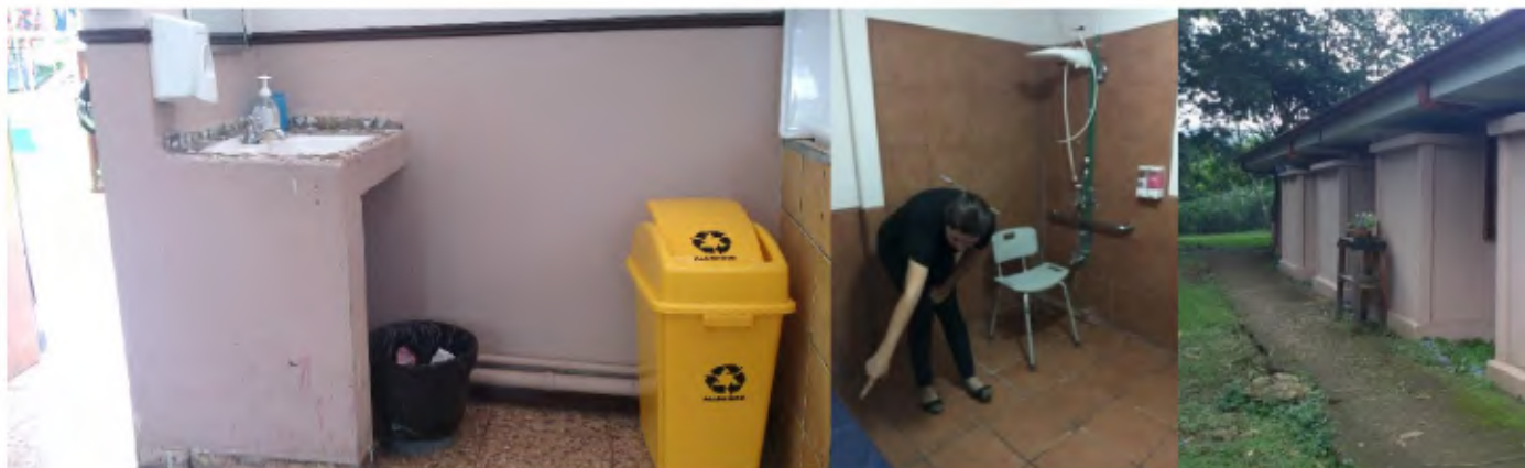
Imagen 2.17: Pilas inaccesibles (izq.) (noviembre 2013) Imagen 2.18: Estructuras incómodas (centro) (noviembre 2016) Imagen 2.19: Materiales en piso desgastados y ásperos (der.) (marzo 2016) Fuentes: Propia
